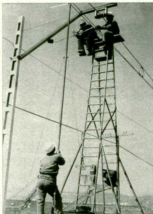
La electrificación de la línea Sevilla-Huelva fue terminada en 1978.
