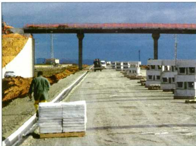
Las obras del enlace La Sagra Toledo supondrán inversiones por 204,6 millones de euros.
