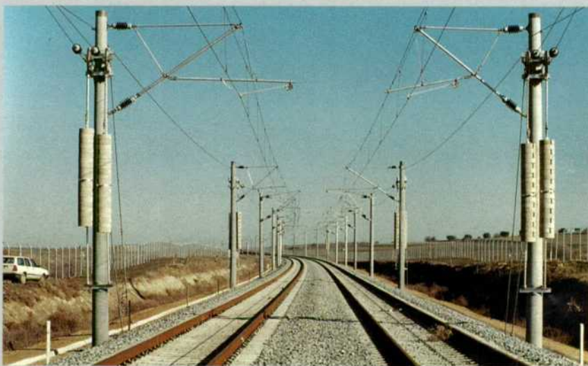
Postes adecuados para las instalaciones eléctricas aéreas.
