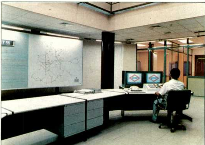
Puesto central del telemando de CMM
