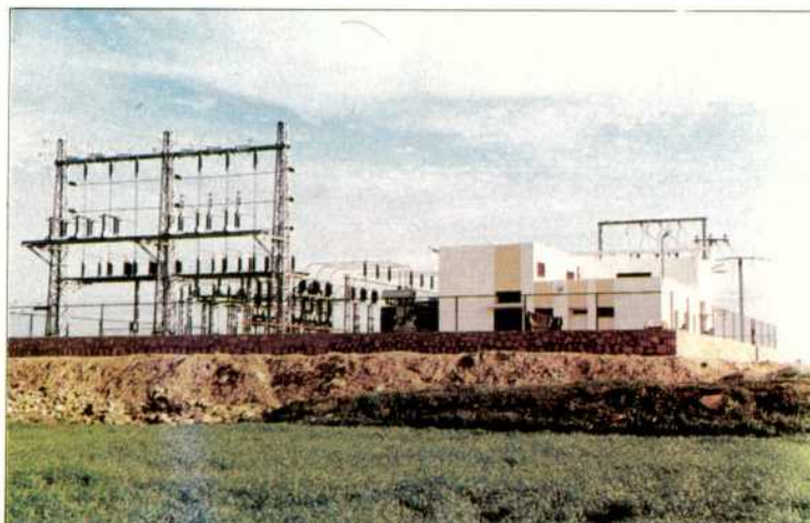
Subestación rectificadora para la ONCF
