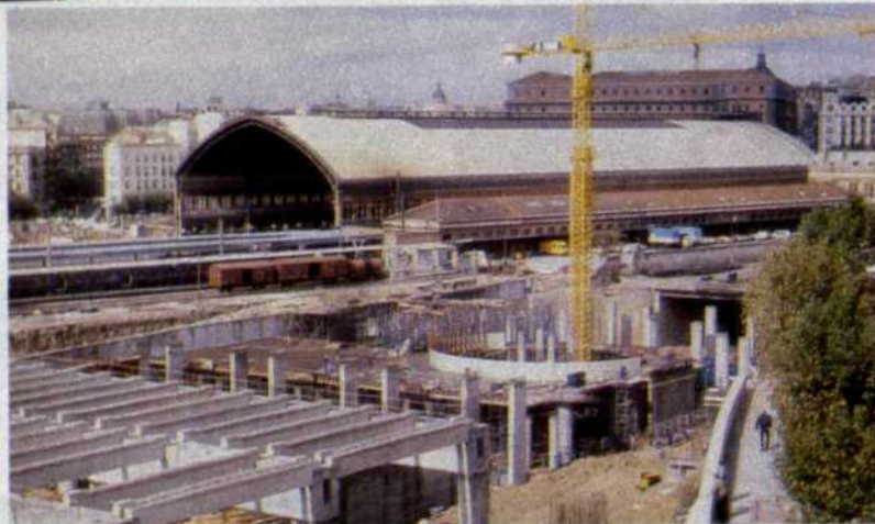
Además de la vigueta de la cubierta se observa el encofrado circular del intercambiador (octubre 1986).
