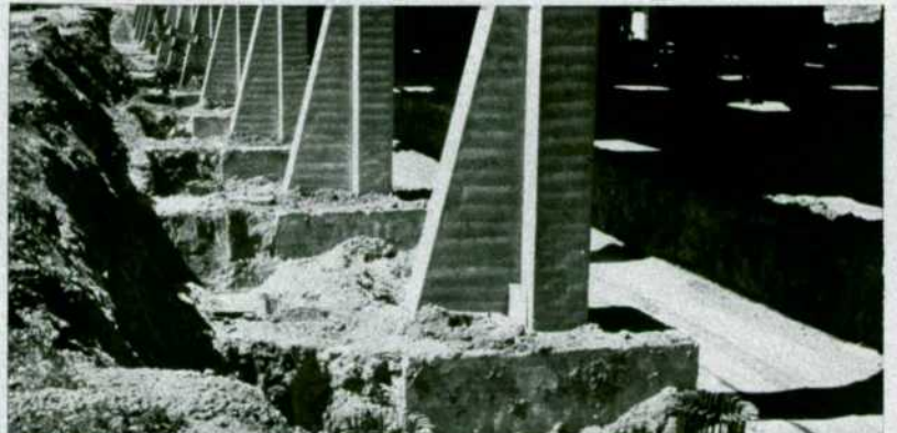
Excavación para realizar las zapatas del muro de cerramiento de la parte Oeste de la estación. Se ven las armaduras de los pilotes fabricados «in situ» que ha sido preciso realizar por mala calidad del terreno (5 de mayo de 1987).
