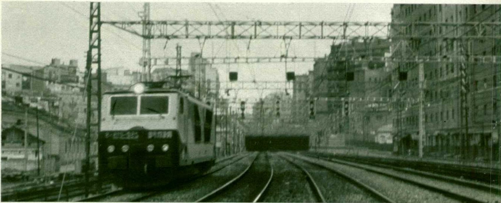
La sustentación en pórticos rígidos es capaz de resistir, con unos tirantes muy cortos, el peso de las seis catenarias incluso el de las doce del seccionamiento, según los tipos.
