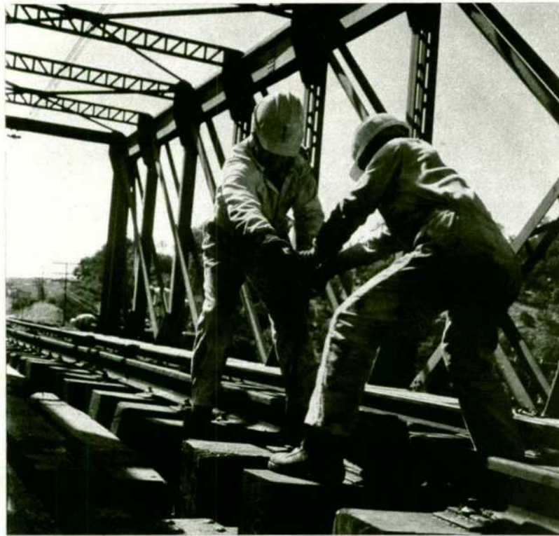
La utilización de prendas de protección es un aliado fundamental en la prevención de accidentes.
